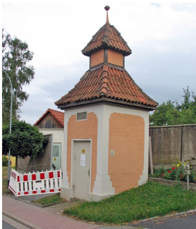
alte Trafostation in Oppershausen, Baujahr 1911, 2013
