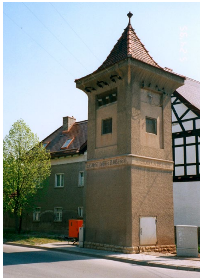
alte Turmstation in Burgwenden vor der Sanierung, 1994 (Foto [13])
