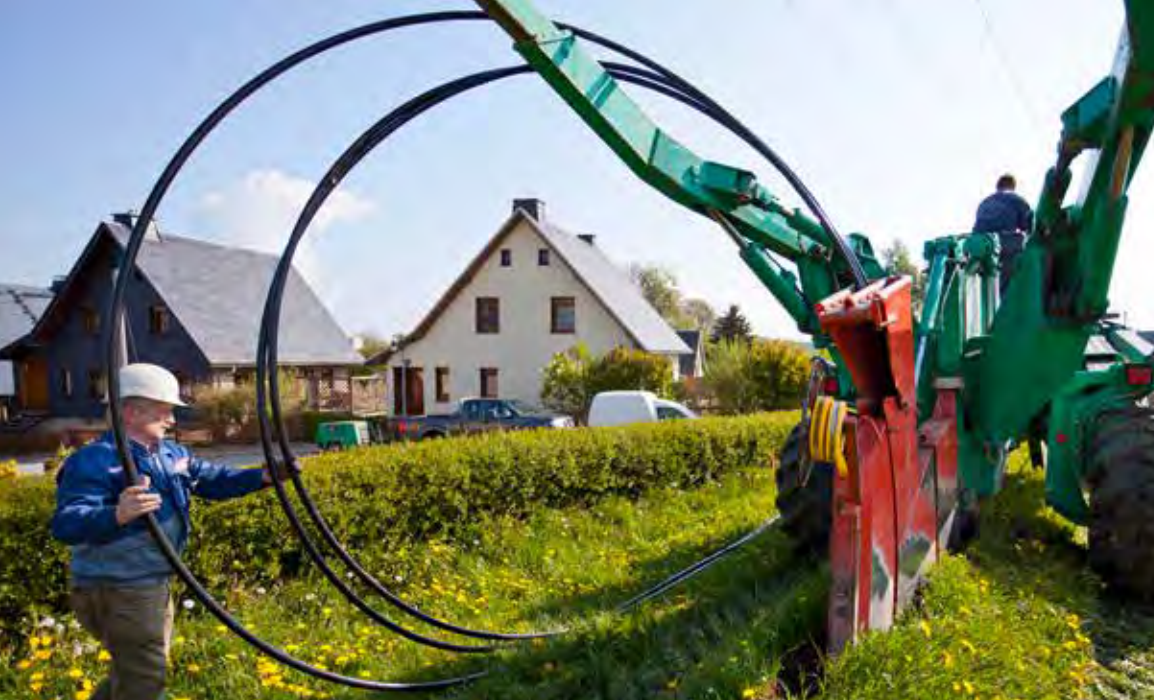
Beim Energienetzausbau kommen moderne Verlege-Technologien zum Einsatz. Etwa Erdpflüge zur Stromkabelverlegung, wie hier im ostthüringischen Drognitz.
