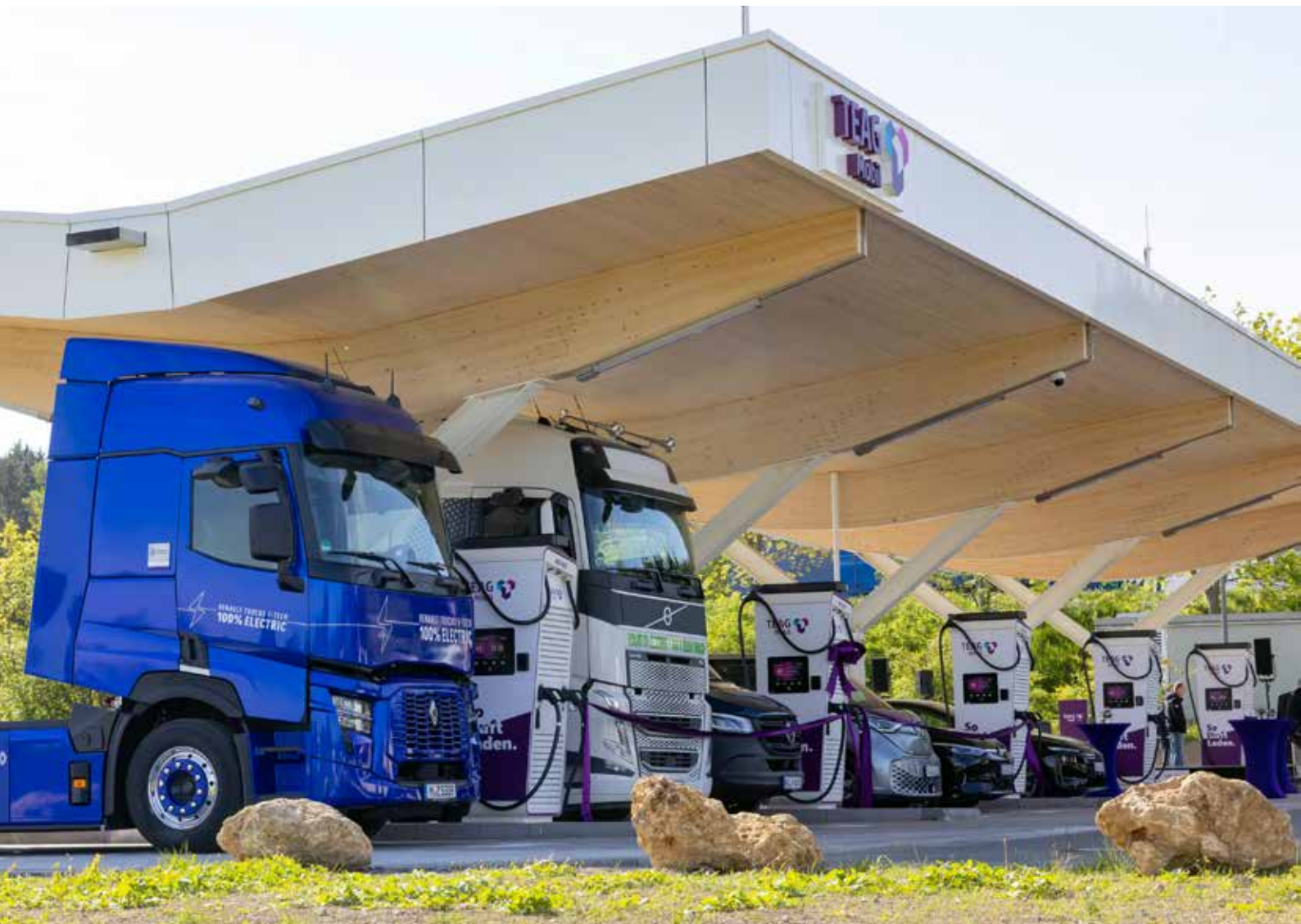
Der Ladepark Schleiz der TEAG Mobil ist wichtig für den Fernverkehr auf der nahen Autobahn A9. Für moderne E-Trucks gibt es im Ladepark 40 Ladepunkte mit Ladeleistungen bis 400 kW.
