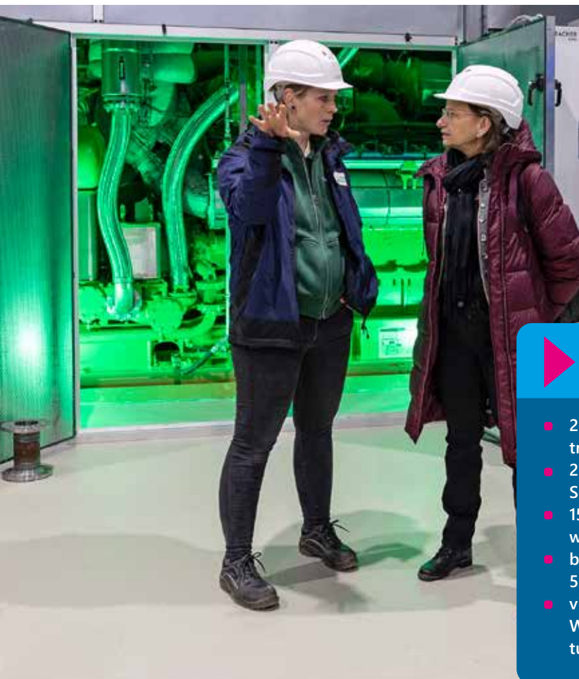
Projektingenieurin Kathrin Wittich (li.) von der TEAG-Wärmetochter TWS hat den Neubau des innovativen Heizwerks in Gera-Langenberg vom Baustart bis zur Inbetriebnahme maßgeblich begleitet.
