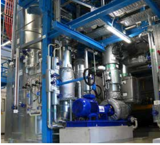
Neu im HKW Bad Salzungen ist die Power-to-Heat-Anlage, die volatil erzeugten EEG-Strom über eine Heißwassergewinnung speicherbar macht.
