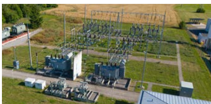
9 In 98646 Hildburghausen: Umspannwerk Weitersrodaer Straße
