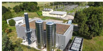
8 In 07552 Gera: Heizkraftwerk und Umspannwerk Auenstraße
